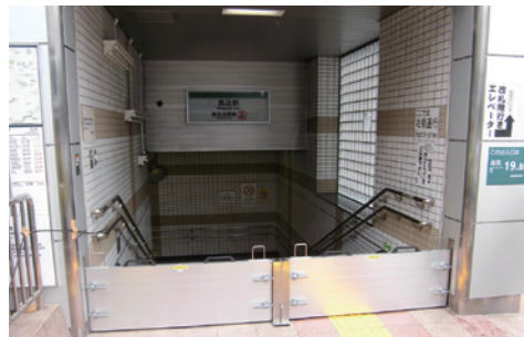
駅の出口に設置された止水板。
