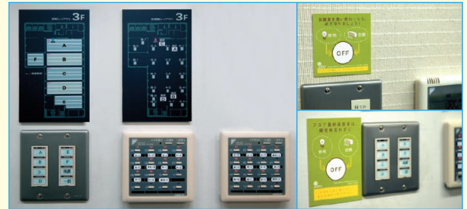
各フロア毎に細かくゾーニングされた電気・空調盤
